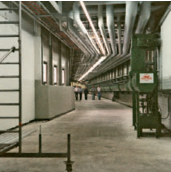
Verbindungsbrücke zur Halle 5 mit Späneförderanlage, 1986
